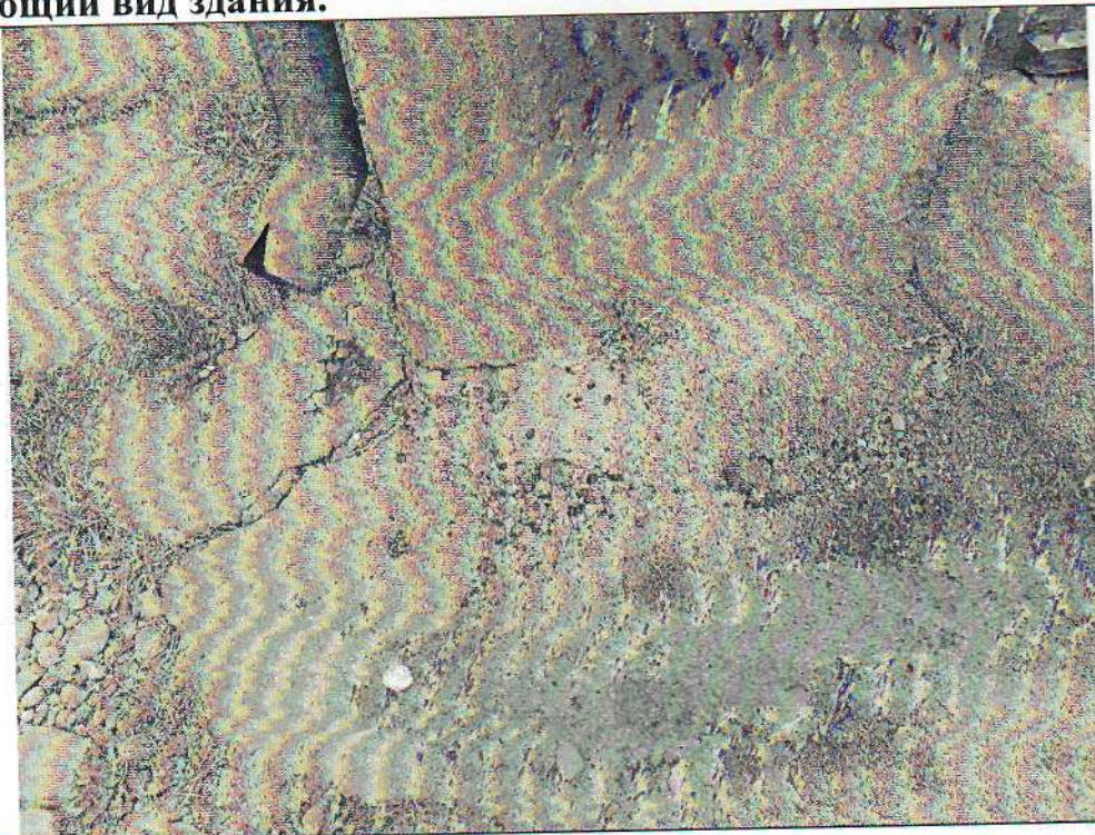
Фото 2. Отмостка здания. На локальных участках наличие разрушений и отхождение отмостки от стен здания. Трещины.
